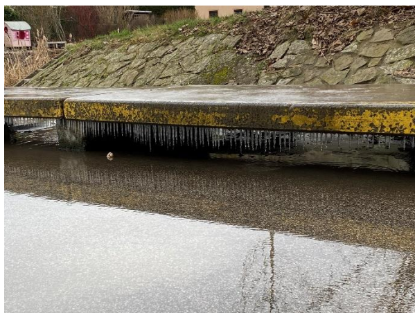
Někdy by se brusle hodily i na chodnících. (ledová vrstva na lávce u brodku)
